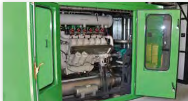
Das Herzstück einer Holzvergaseranlage ist der Gasmotor.
